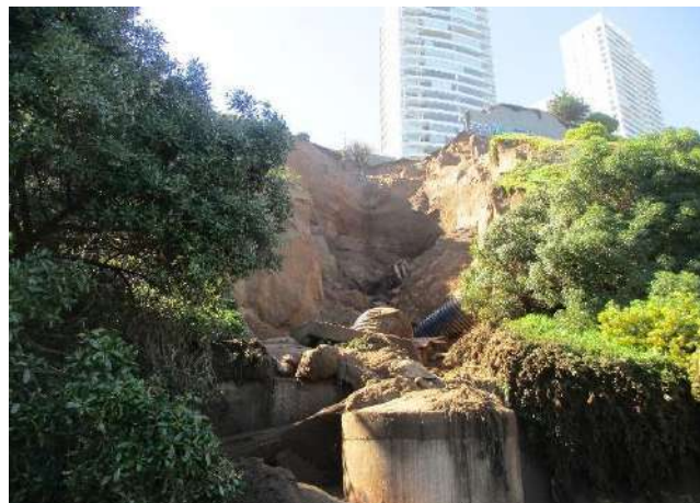
Edificio Kandinsky - Socavón 1
